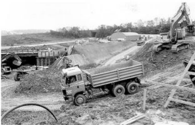
Auf engstem Raum waren am Autobahnanschluss Nentershausen viele Maschinen unterwegs, um das Südportal des Lange-Issel-Tunnels einzurichten.
