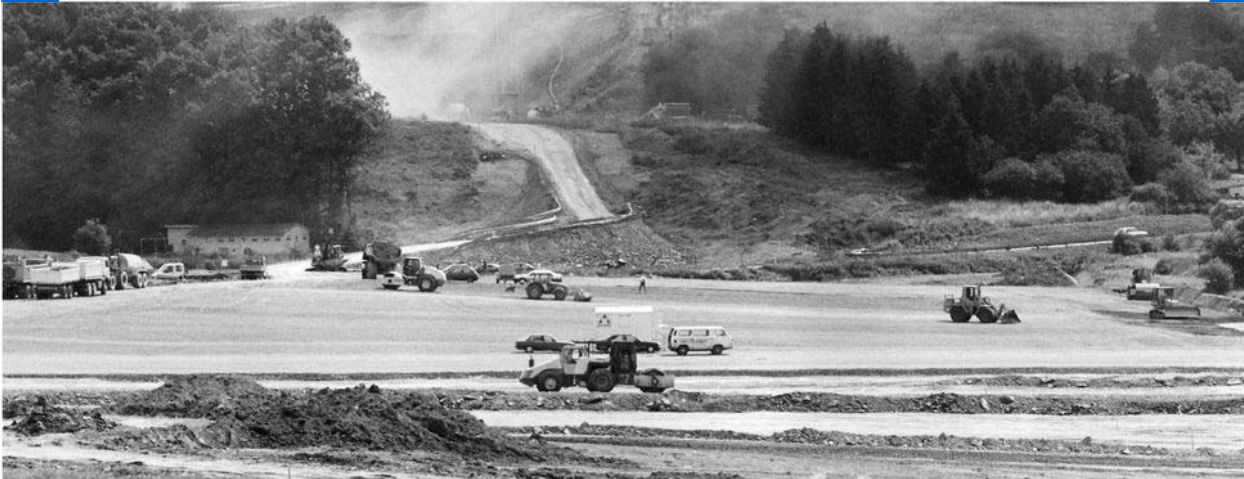
Vor genau 14 Jahren, im August 1998, wurde zwischen dem Nordportal des Himmelbergtunnels und dem Montabaurer Stadtteil Eschelbach mit großem Maschinenaufwand der Boden für den neuen ICE-Bahnhof Montabaur bereitet.
