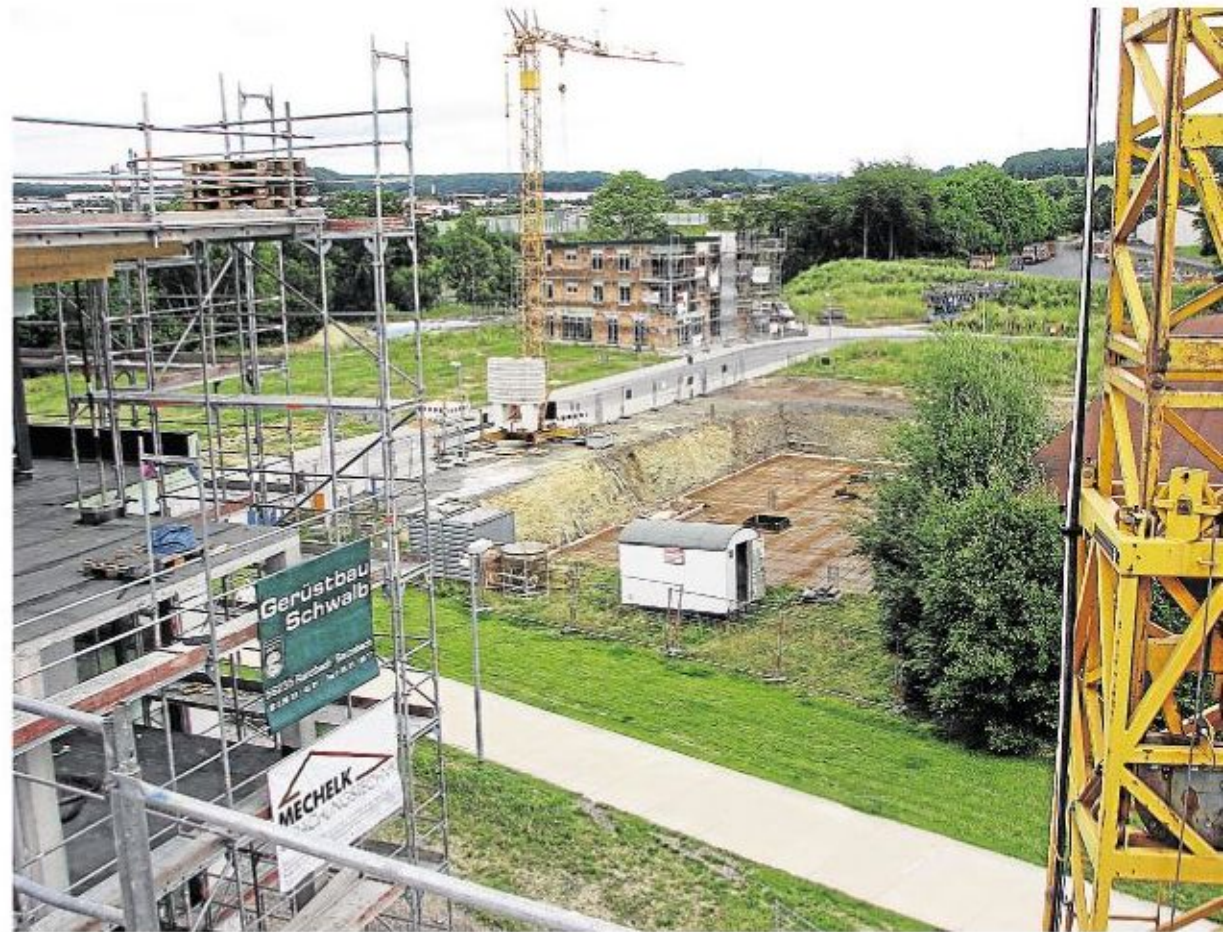
Kräne und Baugruben werden noch einige Monate das Bild im Aubachviertel prägen. Es entsteht ein neuer Stadtteil mit rund zwölf Meter hohen Gebäuden.
